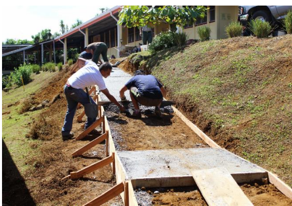
Construcción de Rampa para Escuela Juana Dennis Vives. Foto: Programa de Voluntariado UCR.
